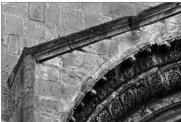
Fig. 4. - S. Domenico, portale. Particolare del protiro sul portale in cui sono evidenti i residui di scialbature.
